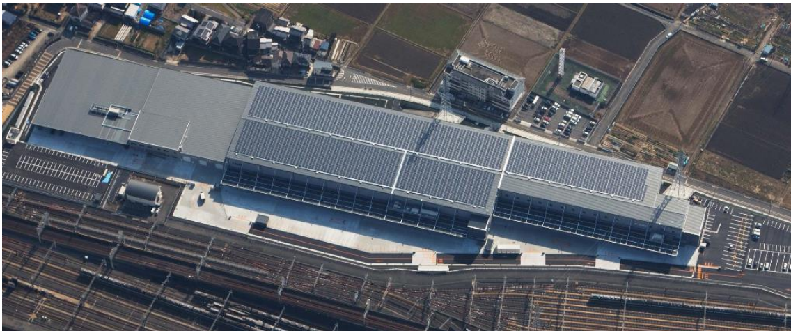
太陽光パネル
