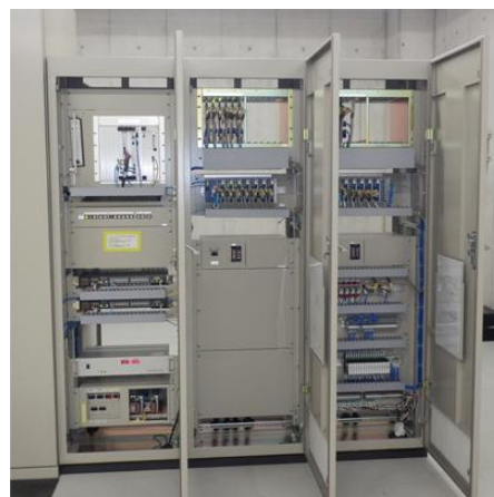
変電所制御装置
