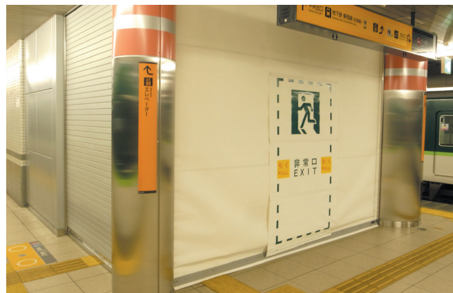
▲防火防煙シャッターが下りた状態
