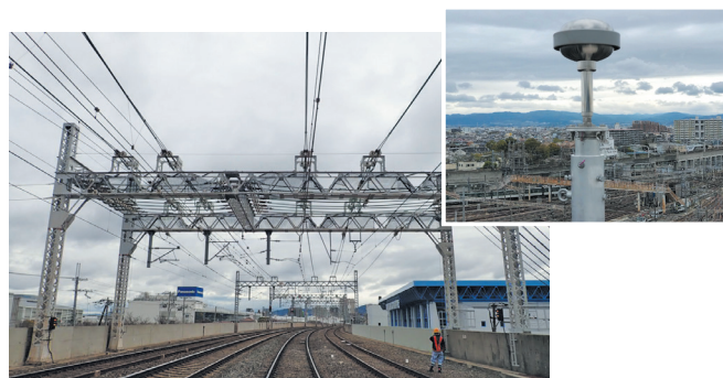
▲守口変電所付近
