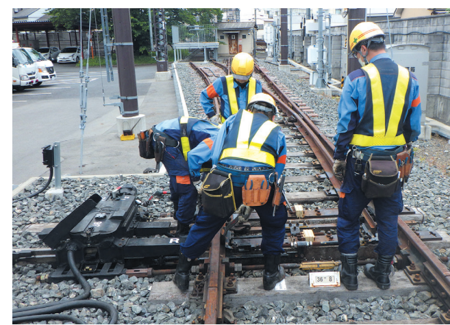
▲ 電気転つ機据付用品の取付・調整訓練
