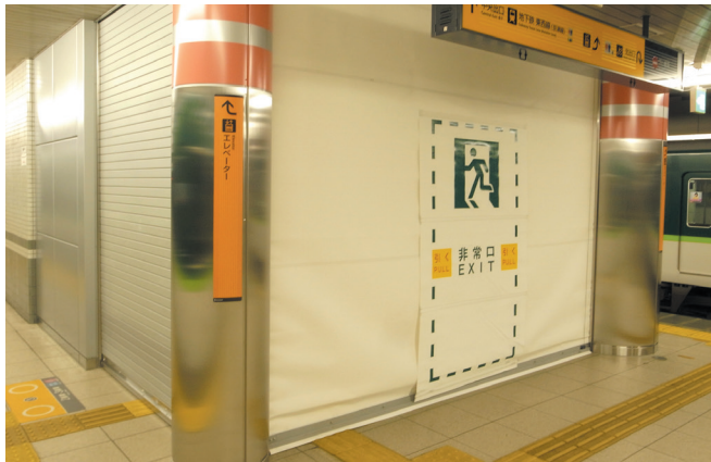
▲防火防煙シャッターが下りた状態
