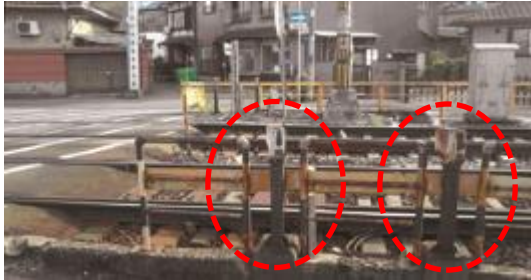
自動車侵入検知装置
