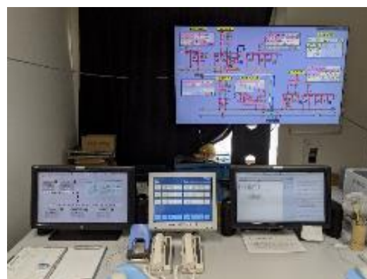
電力管理システム
