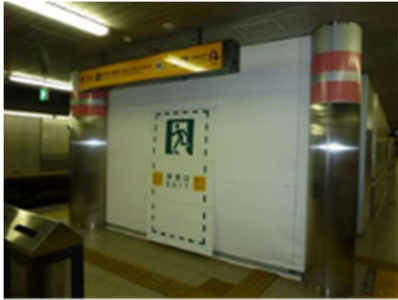
防火防煙シャッターが下りた状態
