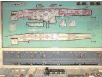
地下線防災監視盤
