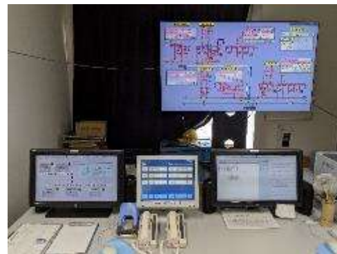
電力管理システム
