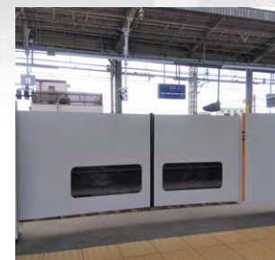
可動式ホーム柵(萱島駅)
