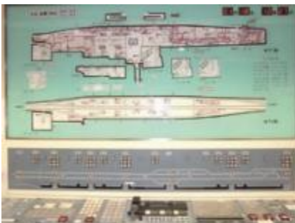
地下線防災監視盤
