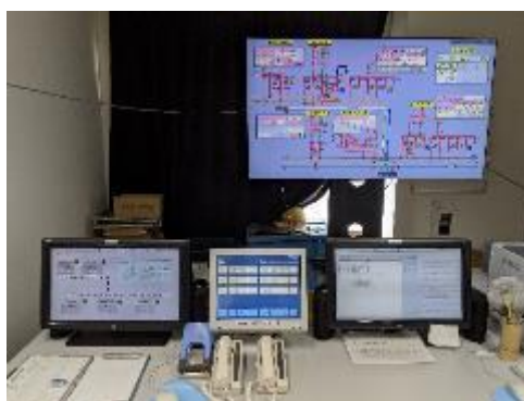
電力管理システム
