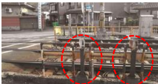
自動車侵入検知装置
