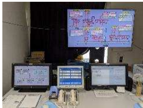
電力管理システム
