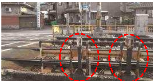
自動車侵入検知装置
