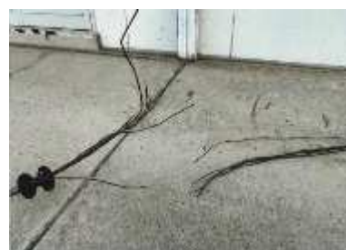
断線した吊架線
