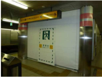
防火防煙シャッターが下りた状態
