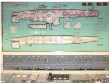
地下線防災監視盤
