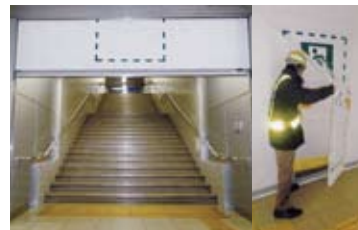
防火防煙シャッター
