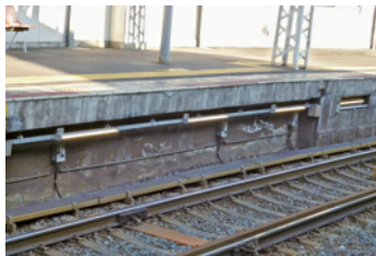
LED足下灯設備
