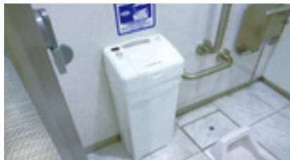
▲女性トイレ衛生設備(中之島駅)
