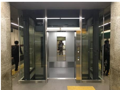
エレベーター
