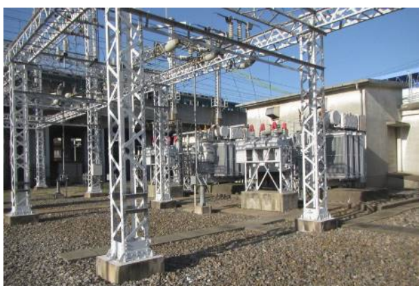
守口変電所の現況
