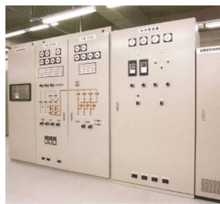
守口変電所内設備機器
