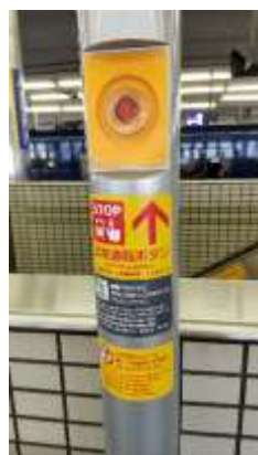
ホーム異常通報装置
