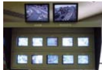
併用軌道監視装置
