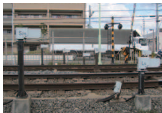
踏切障害物検知装置
