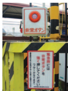
踏切支障報知装置
