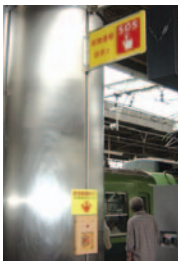
ホーム異常通報装置
