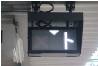
戸閉合図装置 (ホーム上屋に設置)
