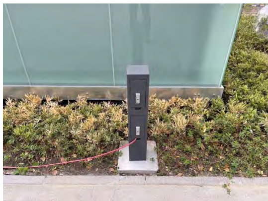
利活用を想定した設備（コンセント）
