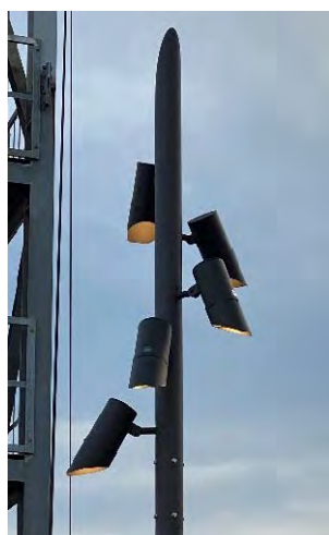
光源にフードを被せることによるグレア抑制の例
