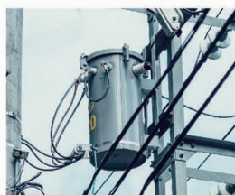
■PCB不使用の変圧器
