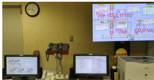
電力管理システム
