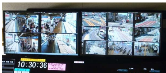
併用軌道監視装置
