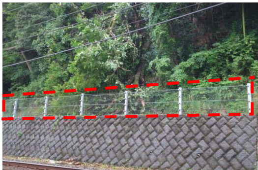
土砂崩壊検知装置
