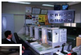
路面監視用テレビ
