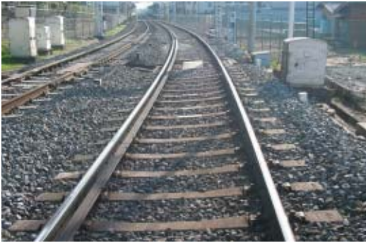
脱線防止ガードレール
