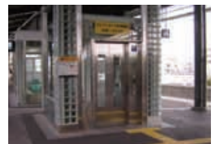
萱島駅エレベーター
