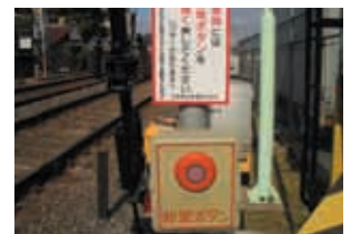
踏切支障報知装置
